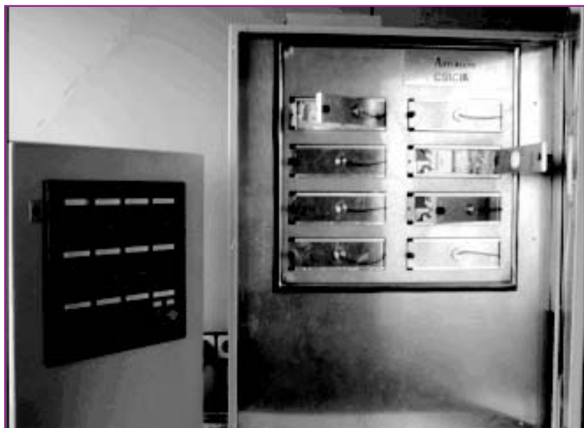
Figura 7.- Cámara de medida y cuadro de control de climatización
